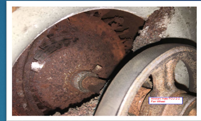
Fan Wheel without Fan Blades (rusted off)
