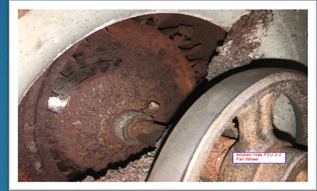
Fan Wheel without Fan Blades (rusted off)
